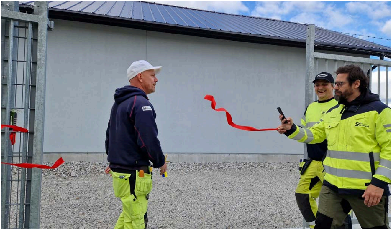
Entreprenaden för att bygga nya fördelningsstationen Östra station startade i juni 2023 och färdigställdes i maj 2024. Driftsättning av stationen gjordes i september 2024, enligt tidplan. Bild från invigningen av stationen.
